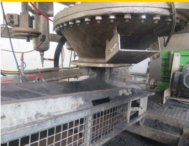
Trockener Kohle-Filterkuchen fällt aus der Schleuse
