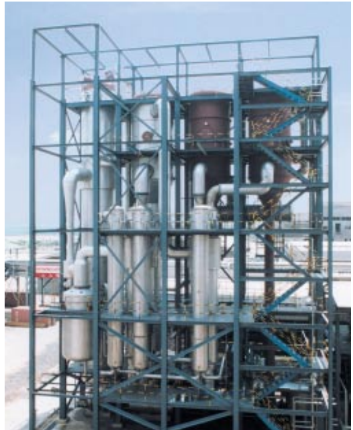
3-stufige Fallstrom-Zwangsumlauf-Eindampfanlage mit thermischer Brüdenverdichtung für Abwasser aus der Natriumglutamatproduktion, Verdampfleistung: 50 t/h
